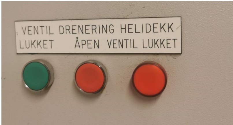
Figur 10: Knappene i pumperommet for å åpne/lukke ventil til avløpssystem (bilde er tilsendt fra leder for plasstjenesten Bergen helikopterlandingsplass).
