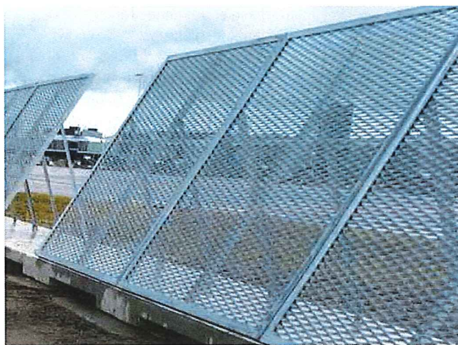
Sikkerhetsgjerde som styrer vind (blast-fence)
